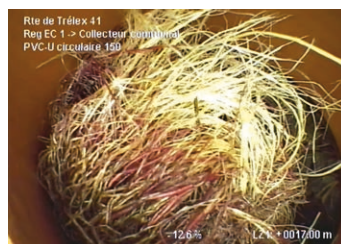
Végétation dans la conduite... puis inondation dans la cave.
