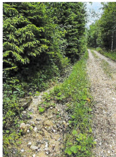
Les exutoires sont obstrués
